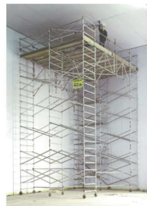
多功能塔架系统
