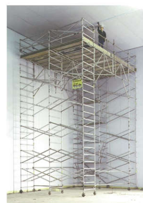
多功能塔架系统
